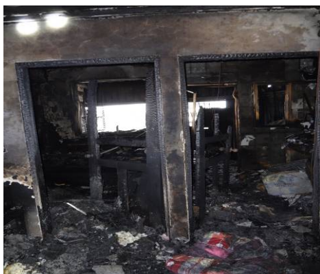
圖五(c)、廚房火災損失程度照片圖
