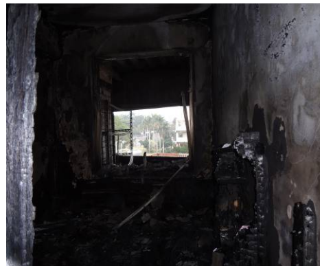
圖五(a)、房間 2 火災損失程度照片圖
