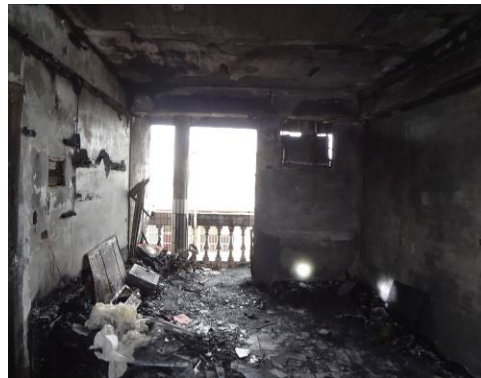
圖五(f)、客廳火災損失程度照片圖
