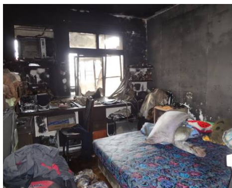
圖五(e)、房間 3 火災損失程度照片圖
