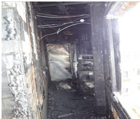
圖五(a)、廚房火災損失程度照片圖
