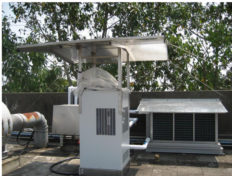
圖 8、散熱端之冰水主機。
