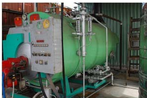
圖 2 乳化重油所使用之鍋爐設備
