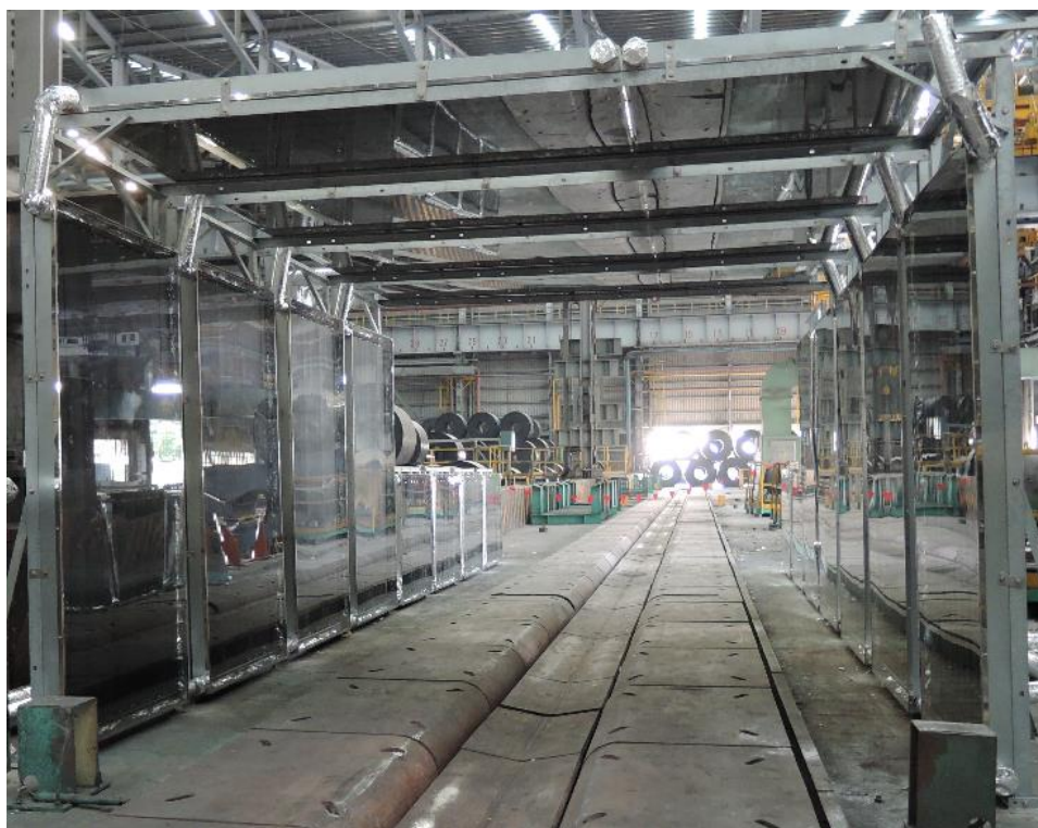
圖 5、工業現場大型輻射熱回收系統
